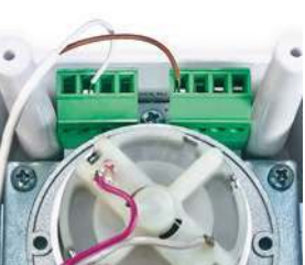
Фото 11. Подключение датчика к электроприводу
