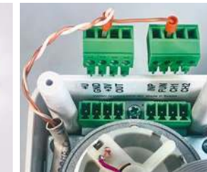
Фото 18. Подключение проводного выключателя к электроприводу
